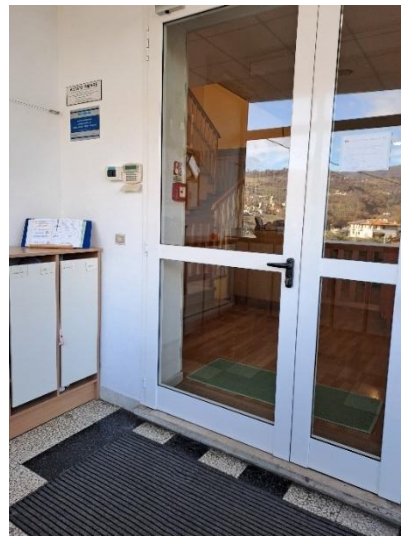
Dislivello in corrispondenza dell'accesso
